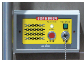
화장실 내 응급호출
